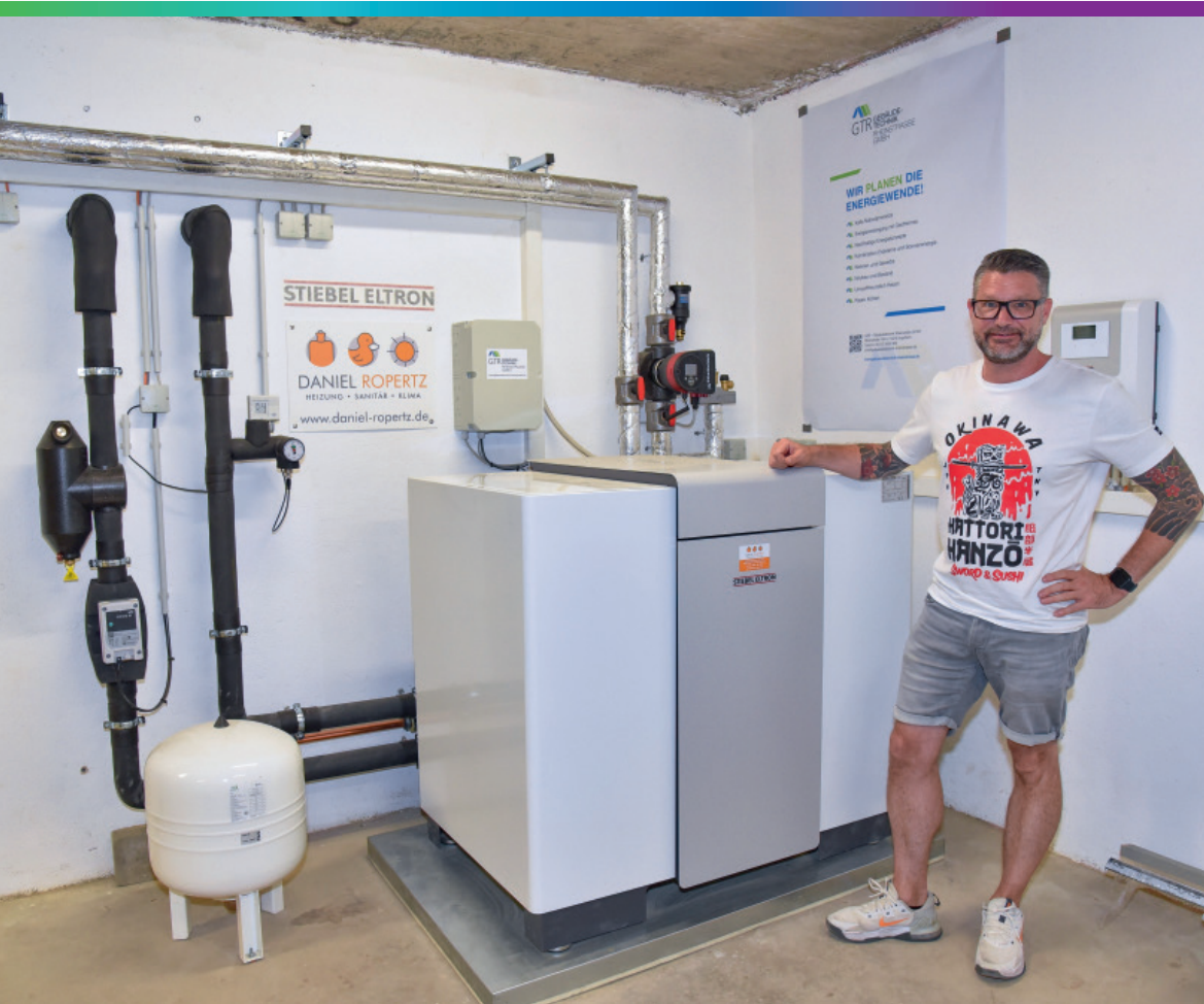
5 Im Heizungskeller des Hinterhauses von Niki Kozisek befindet sich eine 20-kW-Sole/Wasser-Wärmepumpe von Stiebel Eltron (Typ: „WPF 20“). Die schwarzen Rohre sind der Vor- und Rücklauf der kalten Nahwärme, die innerhalb der Gebäude isoliert sein müssen.
